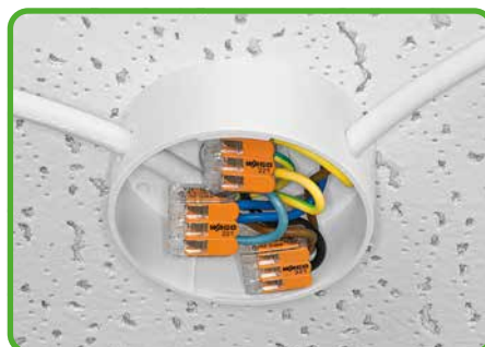
Leuchtenverteilung in Deckenbaldachin
